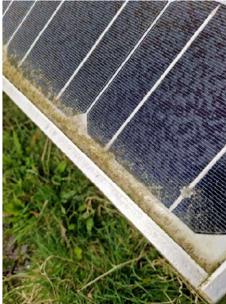
Encrassement de panneaux
