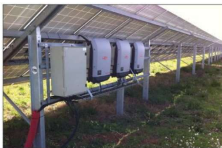
Exemple d'onduleurs strings fixés à l'arrière des tables de modules Source : TSE
